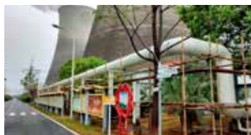
厂区内的蒸汽管道
