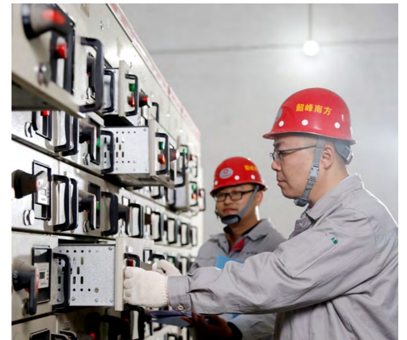
湖南韶峰南方水泥有限公司员工在电气室检查设备情况
