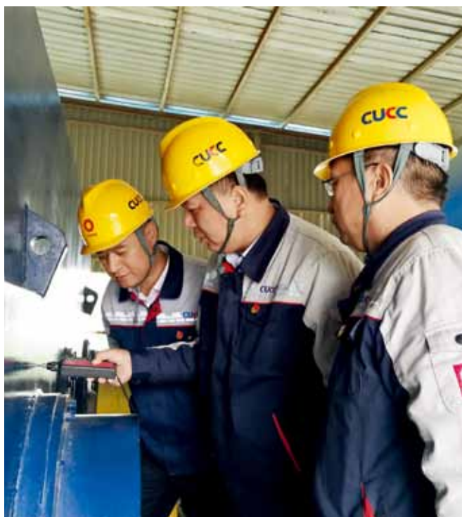
对设备进行巡检
