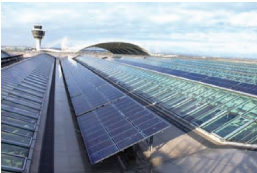
太阳能发电站
