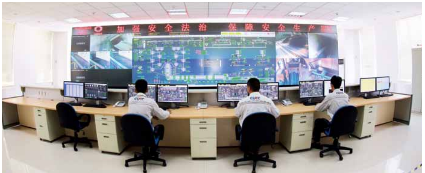
中国建材水泥生产线实现智能化控制
